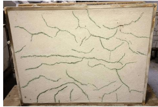
(b) Mapeamento das fissuras com giz de cera
