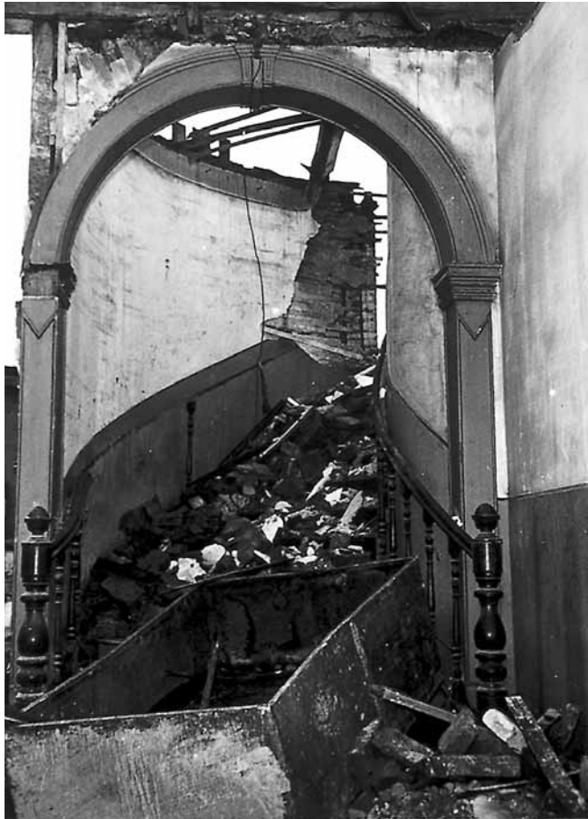
Figura 7 – Aspecto da demolição da antiga casa de José Maria Gavião Peixoto, ocorrida em novembro de 1958. A imagem focalizando a escada nobre permite constatar que na obra haviam sido empregadas diferentes técnicas construtivas. Algumas paredes que sustentavam cargas possuíam estrutura independente de madeira, com vãos preenchidos com tijolos compridos de grandes dimensões, muitos dos quais vistos jogados ao pé da escada. Outras paredes internas tinham a função só de tapamento, como as que acompanhavam a curvatura da escada em espiral. Nessas, o sistema adotado era o das “paredes francesas”, isto é, feitas com estrutura de madeira e vãos fechados com ripas recobertas com reboco. Fotografia anônima, 1958, integrante do caderno Administração Ademar de Barros; monumentos, casas-museu, solenidades, nov./dez., 1958 . Acervo do Arquivo Histórico Municipal Washington Luís (DPH/SMC/PMSP), São Paulo. Reprodução de José Rosael.
