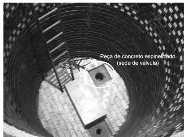
Figura 1: Restrição de espaço do concreto espinelizado em uma panela siderúrgica.
