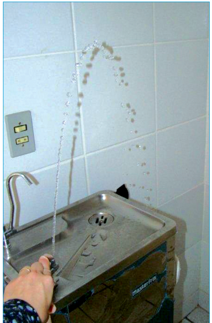
Figura 3 - Jato de água irregular de um dos bebedouros antes do ajuste da vazão.
