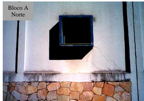
Figura 21 - Fotografia da mesma região da fachada mostrada na Figura 20
