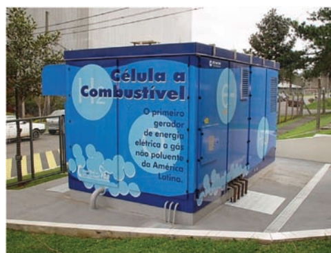
Figura 1. Planta de células a combustível de ácido fosfórico, instalada no LACTEC
