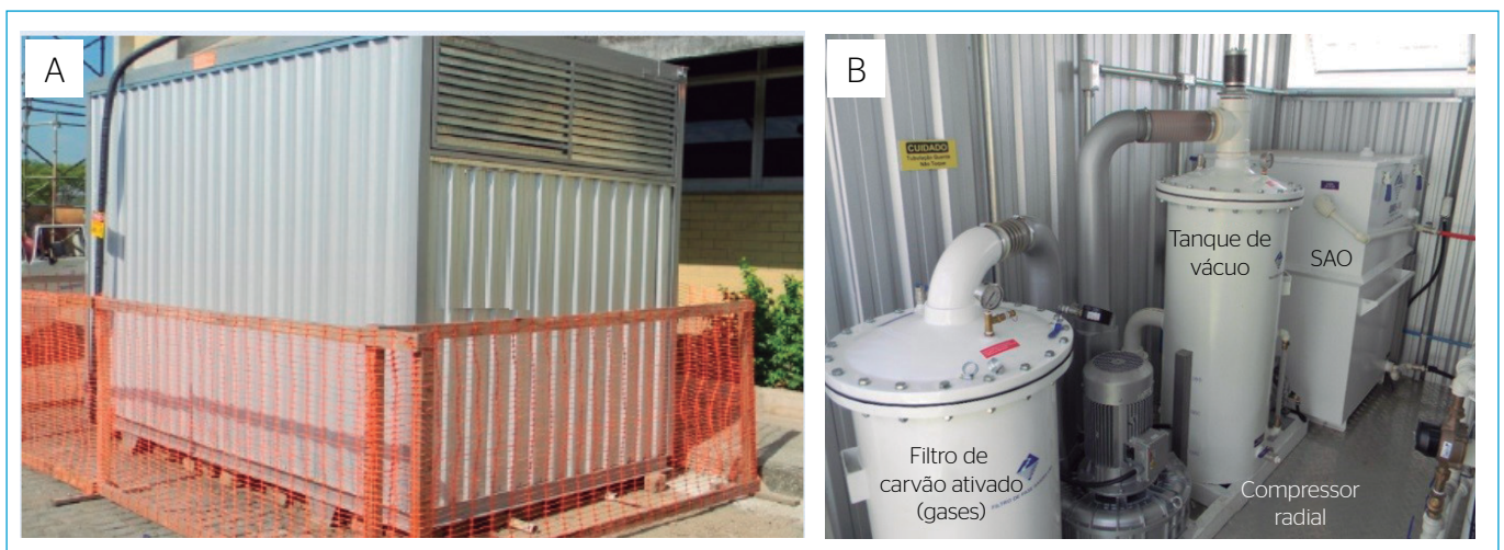
Figura 2 - Visualização do sistema de remediação de extração multifásica e dos seus equipamentos internos.
