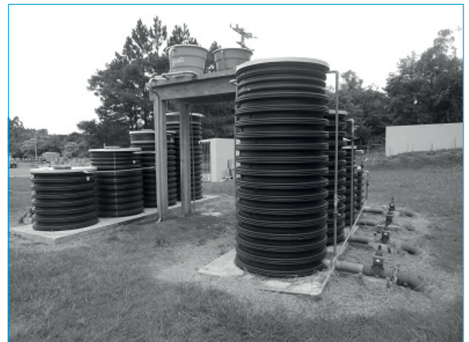
Figura 6 – Cobertura dos reservatórios, caixas distribuidoras de vazão e biofiltros submersos.
