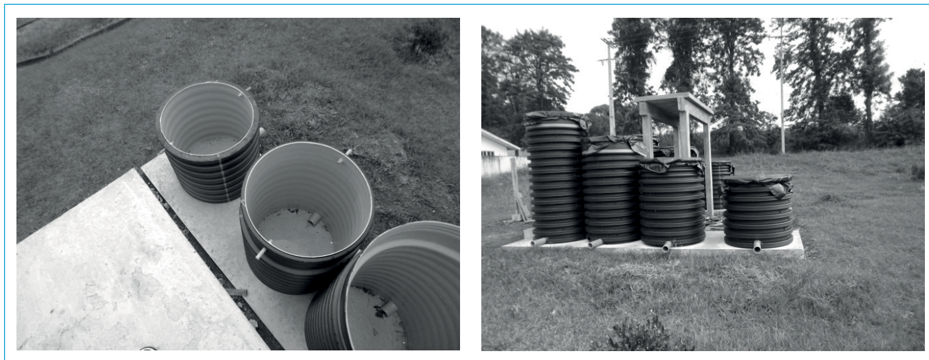
Figura 3 - Biofiltros submersos em polietileno de alta densidade com diâmetro nominal de 1.050 mm revestidos internamente com fibra de vidro.
