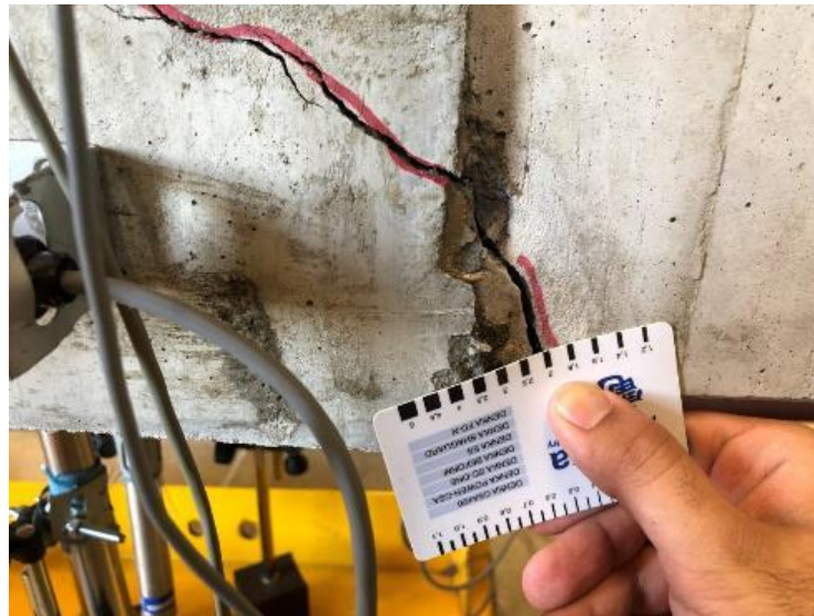
Figura 16: Abertura da fissura no momento do primeiro descarregamento. (Fonte: o autor).
