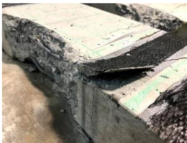
Figura 13: Descolamento do reforço de CFRP.
