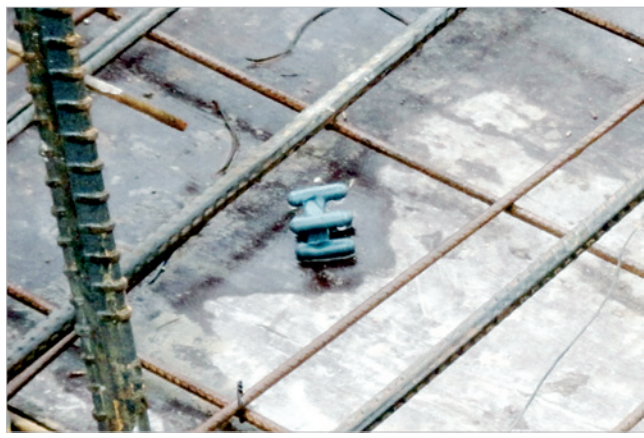
Figura 5 – Espaçador tombado durante um concretagem
