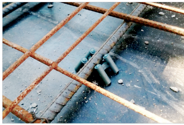
Figura 6 – Deformação do espaçador diante da carga em serviço
