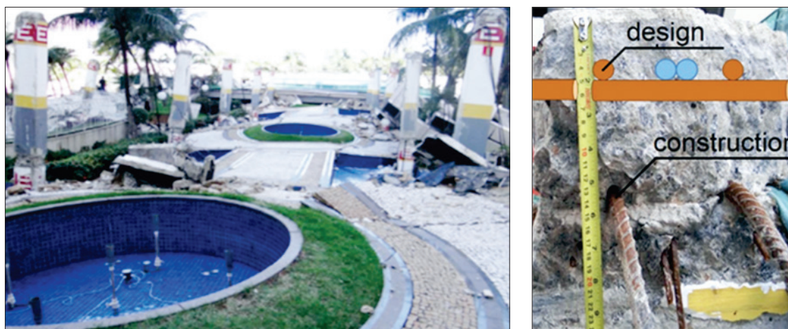
Visão geral da estrutura após o colapso
