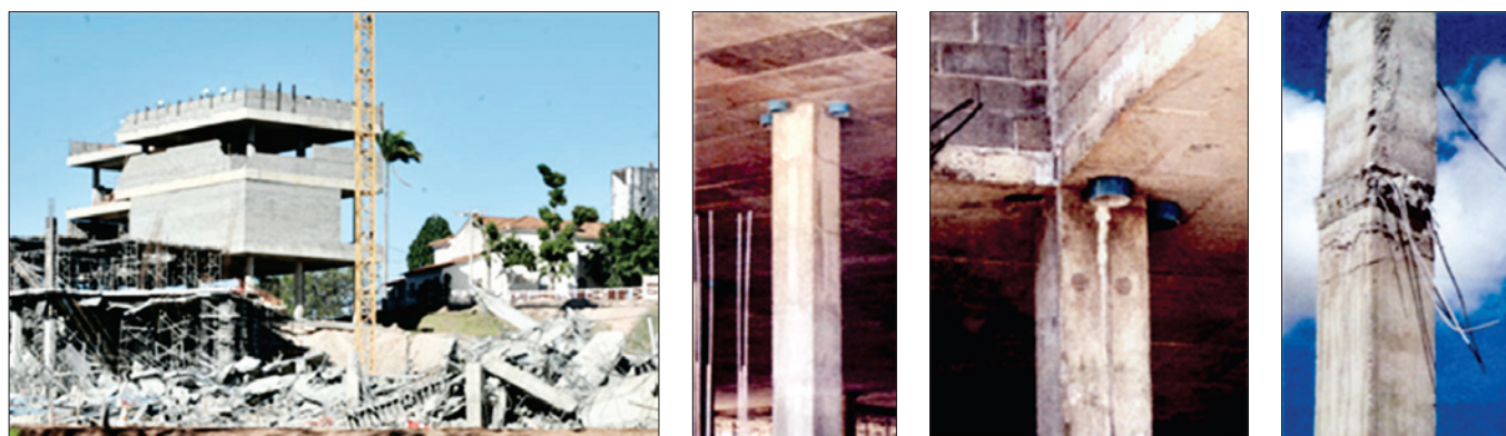
Visão geral da estrutura após o colapso
