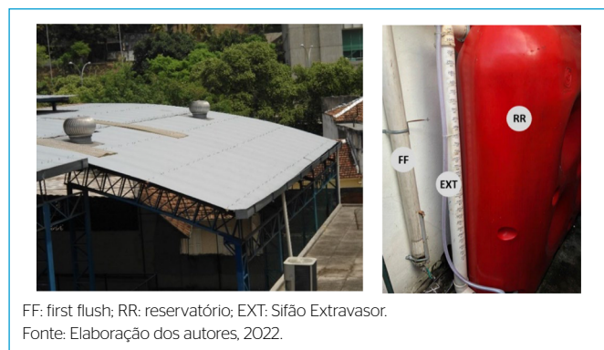
Figura 2 - Superfície de captação em telhado metálico (à esquerda) e Sistema de Águas Pluviais (à direita).
