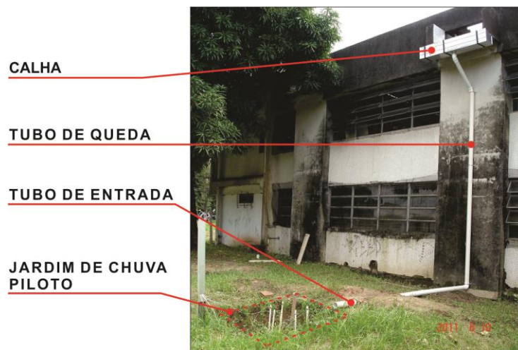
Figura 5 - Conjunto para captação das águas superficiais do telhado para o jardim de chuva piloto da UFPE
