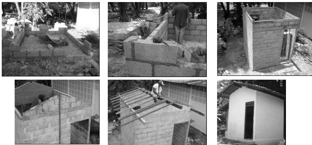
Figura 2 - Execução do protótipo com uso dos blocos EVA na área externa do LABEME/CT/UFPB
