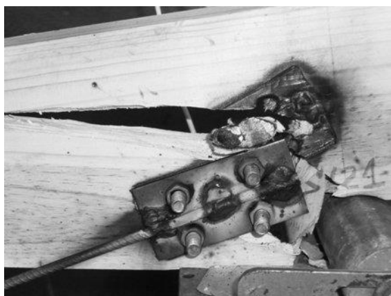
(a) Ruptura na região de fixação da chapa
