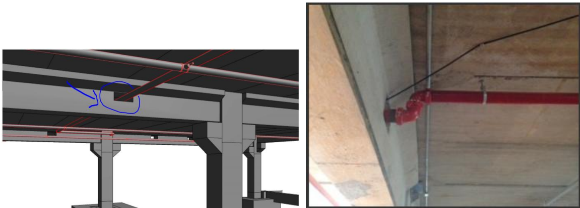
Figura 13 - Trecho executado diferente do previsto em projeto
