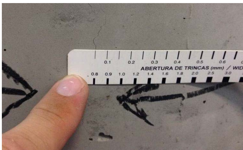
Figura 8 - Fissuração da amostra CR 1 do concreto de referência
