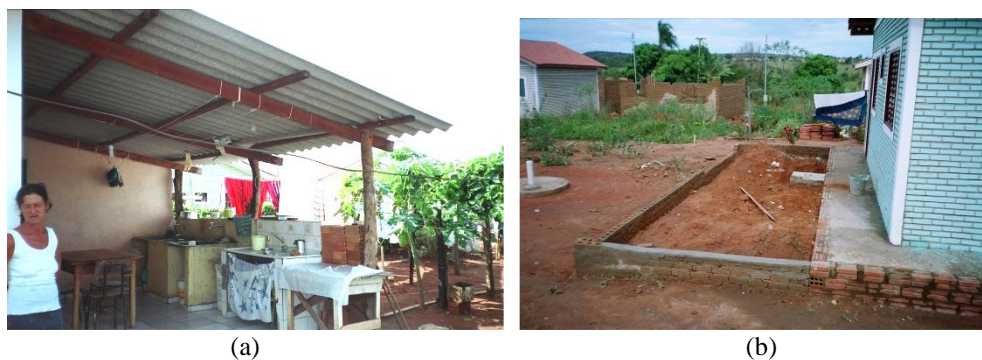
Figura 5 - Ampliações aos fundos: (a) construção de área multiuso, com tanque de lavar, pia de cozinha e mesa para refeições; e (b) preparação de alicerce
