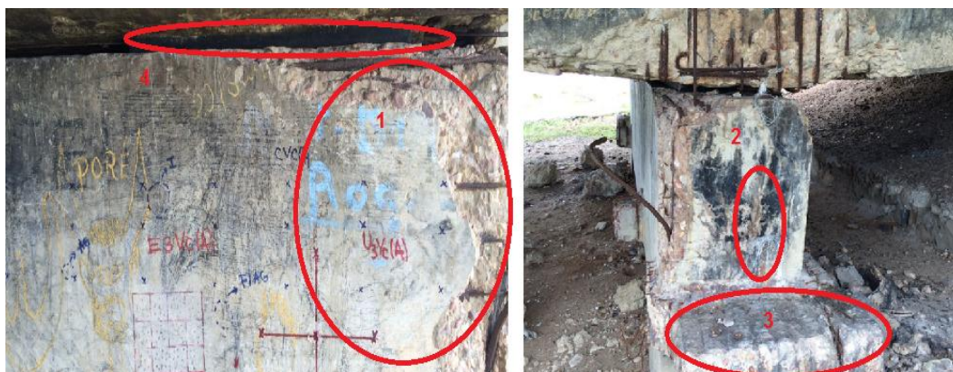
Figura 6 - Manifestações patológicas na mesoestrutura; (1) deslocamento e armaduras corroídas, (2) processo de fissuração, (3) consoles com cobrimento insuficiente e armaduras expostas e corroídas, (4) desgaste e esmagamento do neoprene
