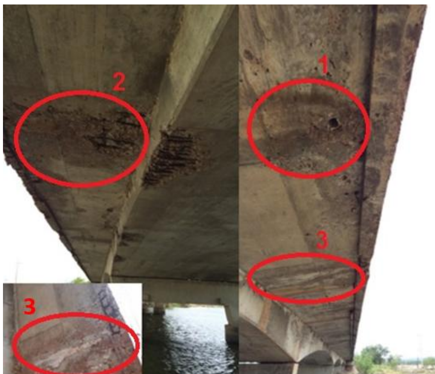
Figura 5 - Manifestações patológicas encontradas nos balanços da face interna da laje superior; (1) manchas de umidade e instalação de drenagem disfuncional, (2) desagregação do concreto, (3) eflorescências e manchas de corrosão
