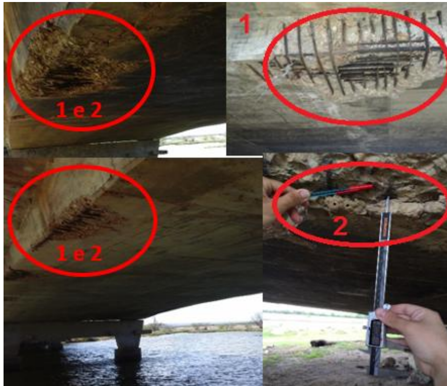
Figura 7 - Manifestações patológicas encontradas no primeiro vão interno da laje inferior; (1) perda de cobrimento e corrosão ativa das armaduras, (2) deslocamento do concreto
