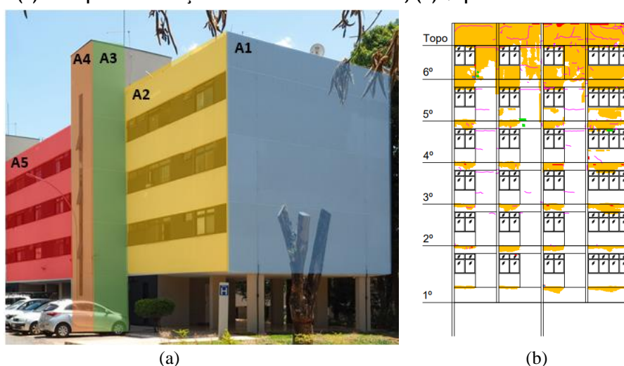
Figura 3 - (a) Exemplo da definição de amostras de fachada; (b) Mapeamento de danos
