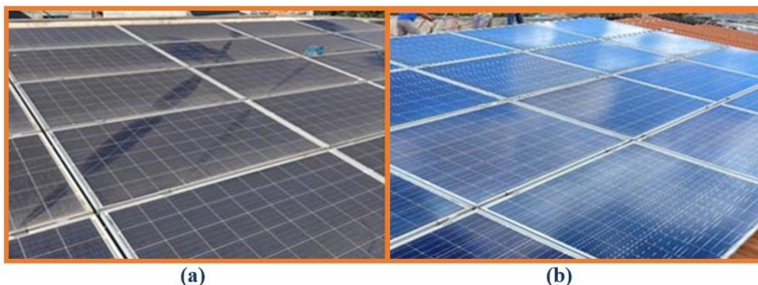
Figura 17 - Superfície dos módulos FV da usina antes (a) e após (b) a limpeza realizada
