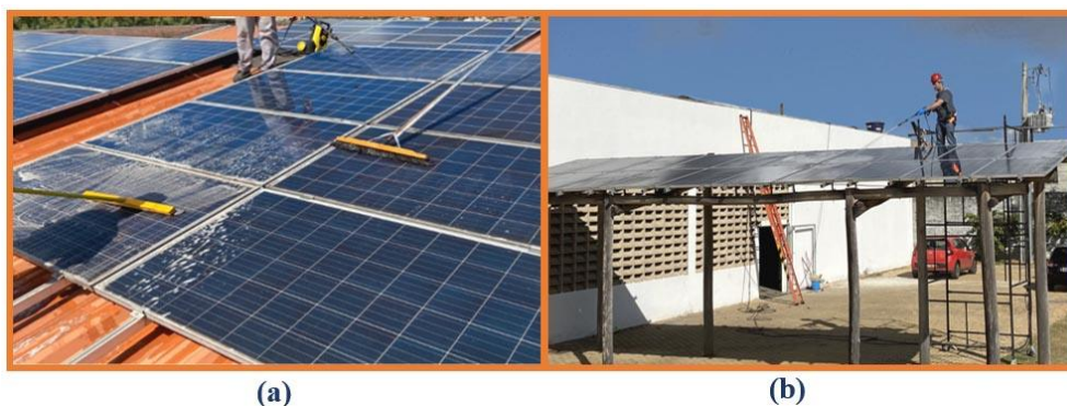
Figura 9 - Limpeza dos módulos sobre cobertura do prédio de laboratórios (a) e sobre estrutura de madeira (b)
