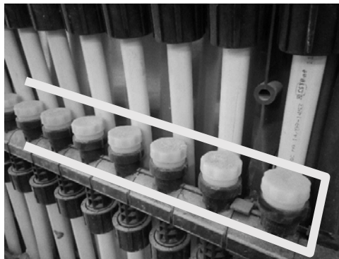
Figura 5 - Válvulas de abertura e fechamento de caudal no coletor de retorno
