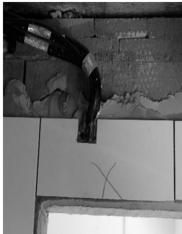
Figura 9 - Tubulação do ar condicionado impediu o correto assentamento da placa cerâmica
