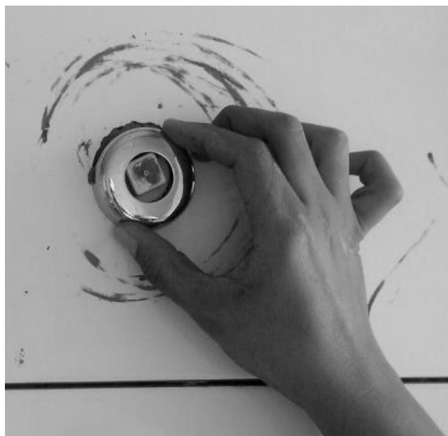
Figura 10 - Rebarba no ponto de água fria
