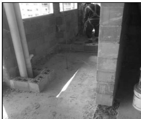
Figura 4 - Exemplo de trabalho inacabado - falta de terminalidade
