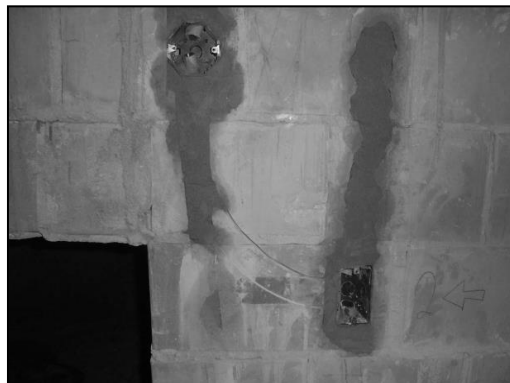
Figura 3 - Exemplo de trabalho inacabado em alvenaria - retrabalho
