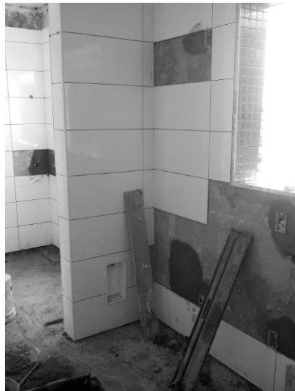
Figura 12 - Arremate das caixinhas interrompido por falta de placas cerâmicas
