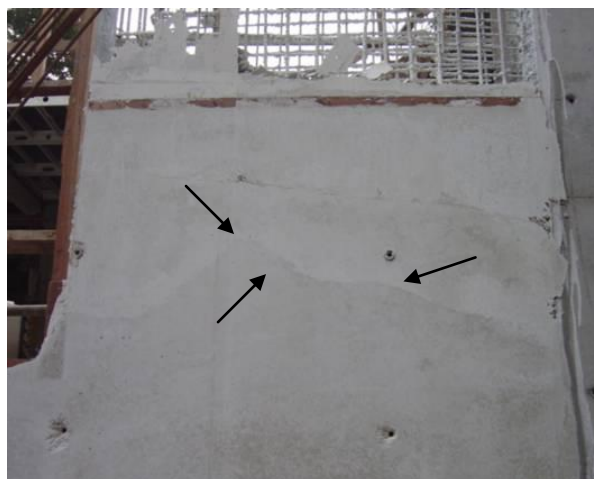
(b) Camadas observadas devido aos problemas de adensamento em função da perda de trabalhabilidade do concreto
