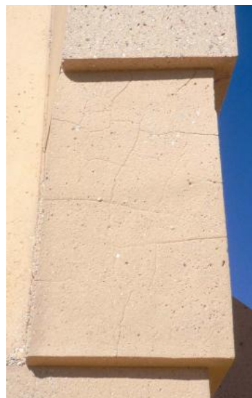
Fonte: Selna e Monteiro (2001) (b) Fissuras de origem térmica
