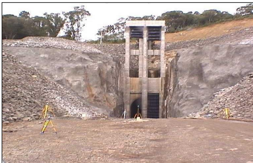
Figura 8: Fotografia tirada pelo próprio equipamento na entrada do túnel, mostrando os diversos tripés com alvos planos, com coordenadas a determinar.
