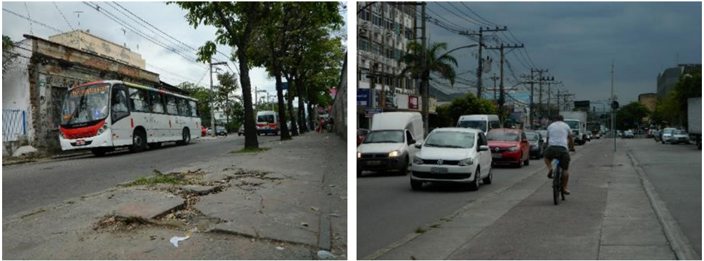
Figura 4 – Condições do piso das ciclovias/ciclofaixas no bairro de Bangu
