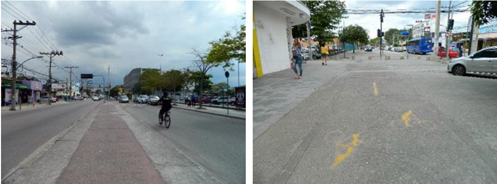
Figura 6 – Condições do piso das cicloviás/ciclofaixas no bairro de Bangu
