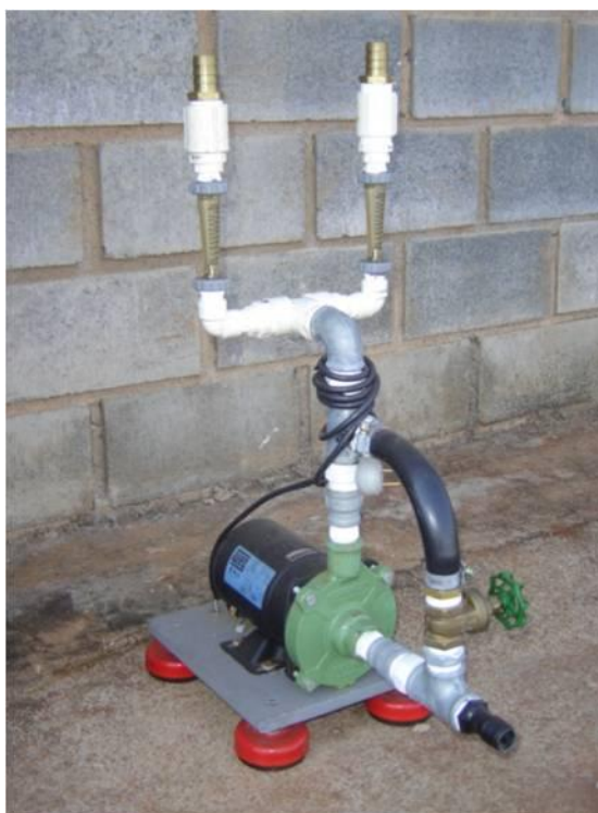
FIGURA 4. Conjunto bomba de água e medidores de fluxo. Set pump and flow meter.
