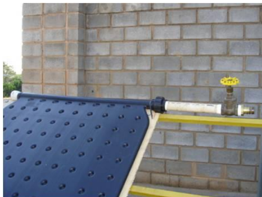
FIGURA 2. Registro para controle de vazão e pressurização. Registration for flow control and pressurization.
