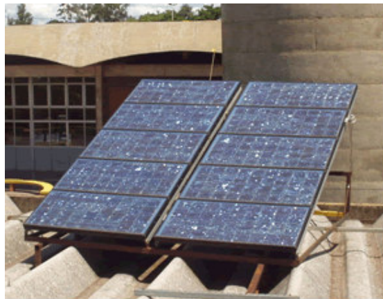
FIGURA 1. Conjunto fotovoltaico. Photovoltaic set.
