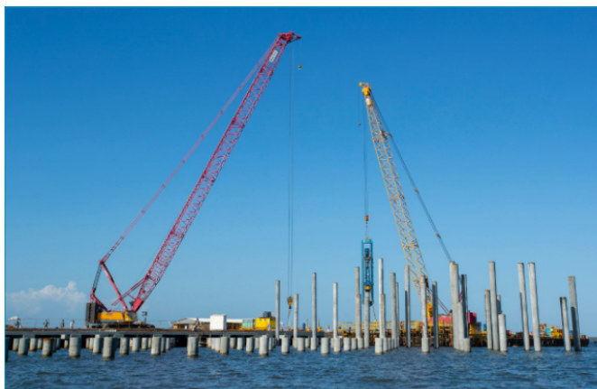
Figura 3 - Atividade de cravação de estacas de concreto e posicionamento em diversos níveis das estacas cravadas e estacas arrasadas.
