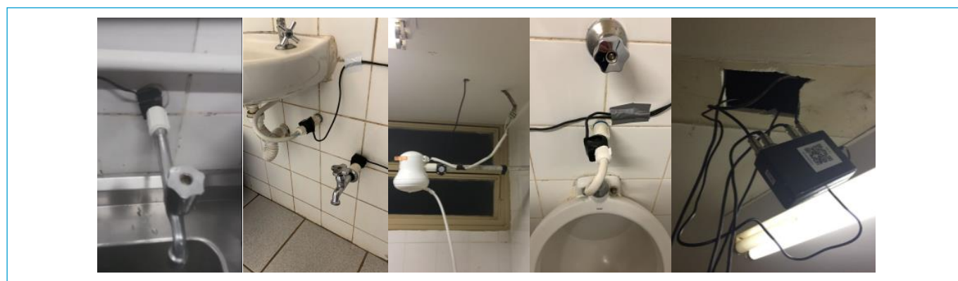
Figura 3 - Medidores de fluxo instalados em torneiras, chuveiros, mictórios e filtros de água, conectados a módulos data logger .
