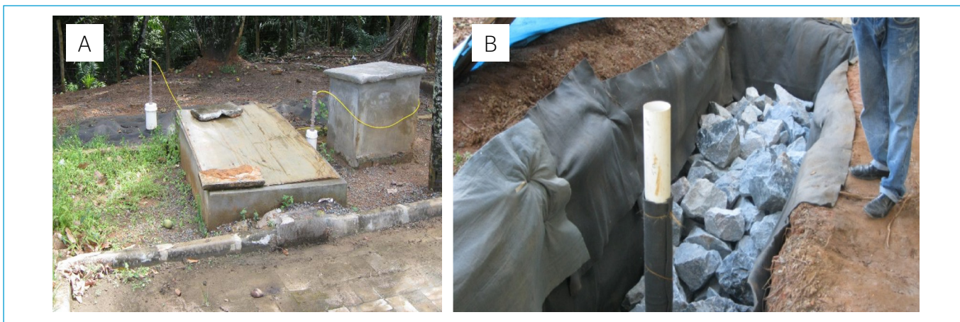
Figura 4 - (A) Localização dos sensores de pressão, destinados à medição do nível da água no vertedor e na trincheira, e detalhes da casa de resguardo dos data logger; (B) detalhe da construção da trincheira de infiltração.
