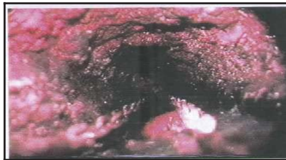
Figura 4 – Incrustação na RCE que recebe a empresa 128 (SABESP, 2004)
