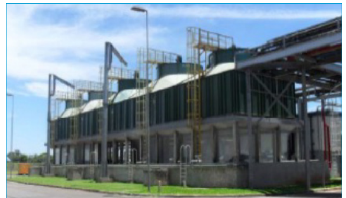
Figura 3 - Torres do sistema de resfriamento de água do setor de pintura da General Motors do Brasil (GMB) de Gravataí (RS), Brasil. Fonte: o autor.
