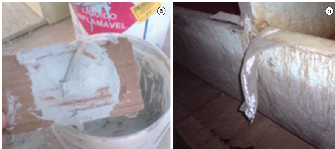
Figura 7. Desperdício decorrente do uso ou preparo excessivo de materiais (abril de 2009): a) massa plástica; b) sobra de tecido de fibra de vidro.
