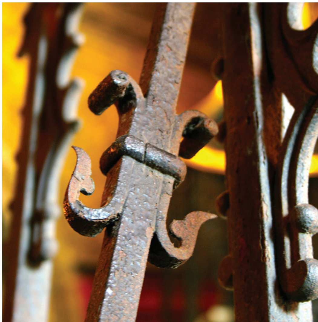
Figura 5: Detalhe de um elemento ornamental em ferro fundido, do Pavilhão Mourisco (Foto: Rosio Moyano, 2009; acervo DPH/COC/Fiocruz)
