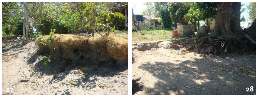
Figuras 27-28: Pontos erodidos do Aterrado do Bananal
