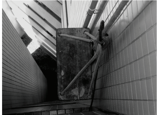
Figura 12. Cadeira suspensa inadequada, sem cabo independente para o cinto – obra F Fonte: pesquisa de campo.
