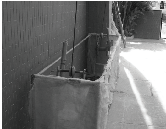
Figura 13. Andaime sem cabo de segurança do travaquedas – obra E. Fonte: pesquisa de campo.
