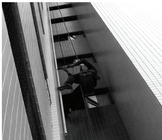
Figura 6. Instalação de tubulação de recalque na fachada – obra F. Fonte: pesquisa de campo.
