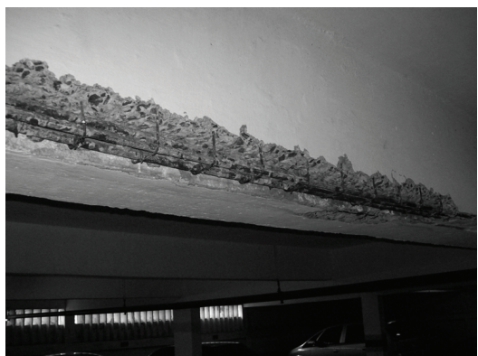
Figura 14. Demolição da estrutura de concreto armado sem escoramento adequado. Fonte: pesquisa de campo.
