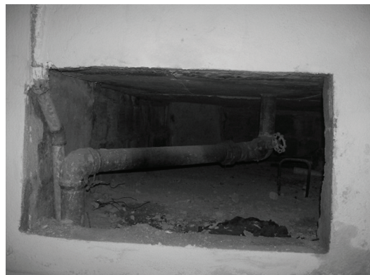
Figura 5. Dificuldade de acesso às instalações hidráulicas do ramal principal – obra C. Fonte: pesquisa de campo.
