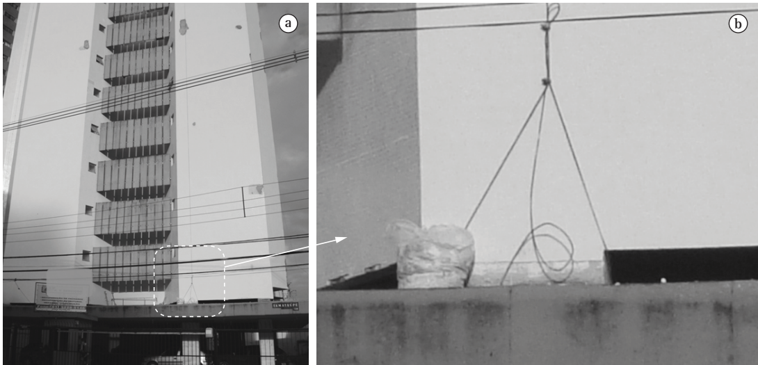
Figura 9. a) Arranjo inadequado do cabo de sustentação da estrutura – obra A. b) Detalhe da fixação inadequada do cabo de segurança – obra A. Fonte: pesquisa de campo.
