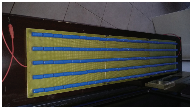
Figura 5: Banco de capacitores 1. Fonte: Os autores.
