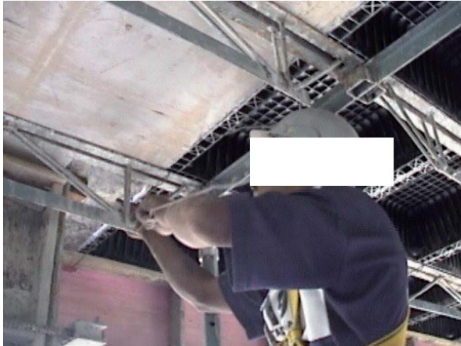
Figura 1 Trabalhador passando o arame para amarração do escoramento da laje com a forma das vigas externas. Belo Horizonte, 2006
