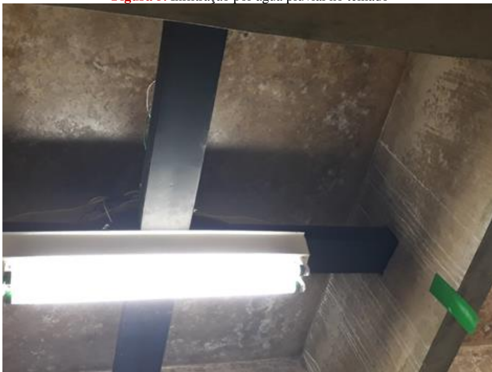
Figura 5. Infiltração por água pluvial no telhado
