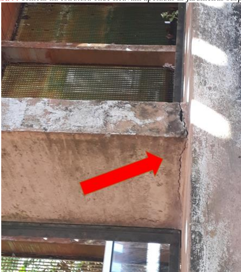
Figura 9. Trincas na estrutura onde ficavam apoiadas as jardineiras suspensas
