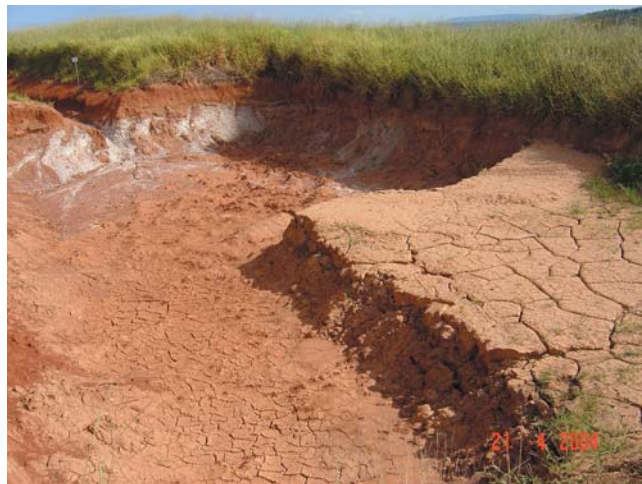
Figura 2 - Bacia de sedimentação parcialmente limpa em abril de 2004. Salientam-se a grande quantidade de material depositado e a revegetação ao longo dos talwegues.
