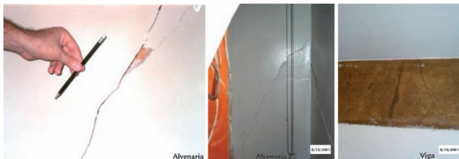
Figura 3 Fissuras nos apartamentos dos fundos.
