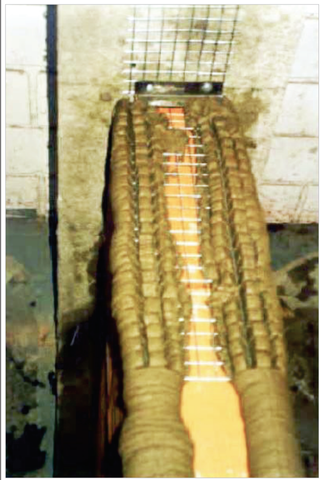
Figura 3 – Detalhe de ligação alvenaria/pilar com o emprego de tela metálica eletro-soldada fixada ao pilar por intermédio de cantoneiras e pinos metálicos (7)
