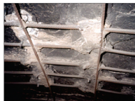
(c) Estilhaçamento violento ( explosive spalling )
