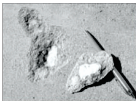
(a) Desprendimentos cônicos ( pop-out )
