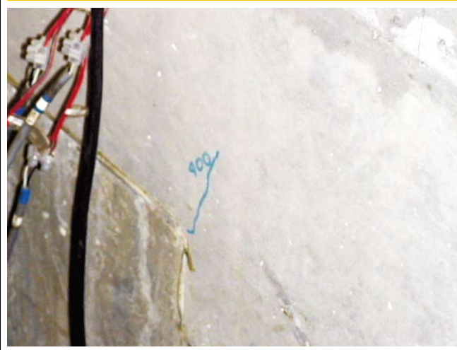
Figura 6 – Posição da primeira fissura (junto à estaca)
