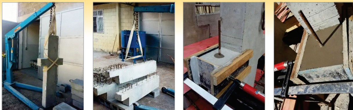
(a) Içamento dos pilares (b) Içamento das vigas (c) Fôrma para almofada de apoio (d) Execução da almofada de apoio
