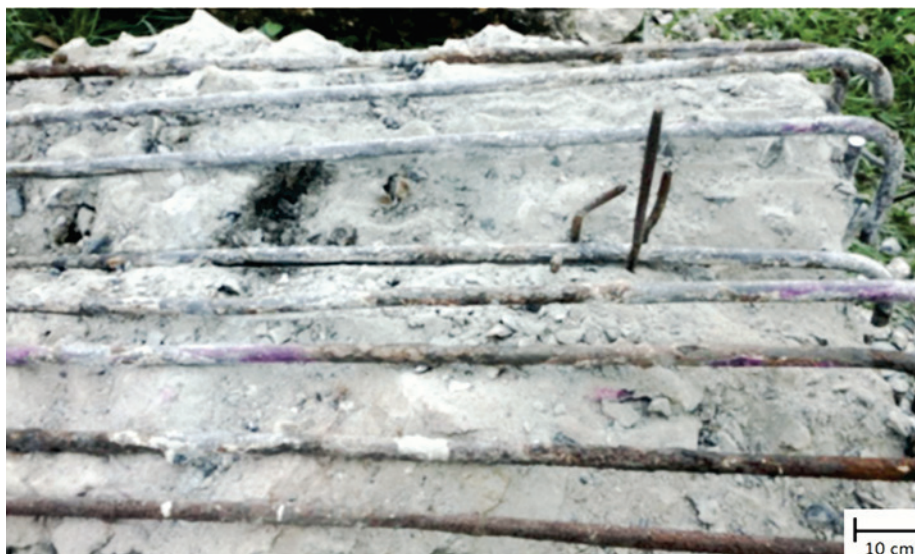
Figura 4 Exposição completa das armaduras do bloco de fundação
