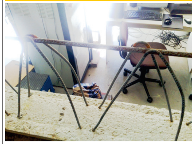
Figura 17 – Flambagem das diagonais
