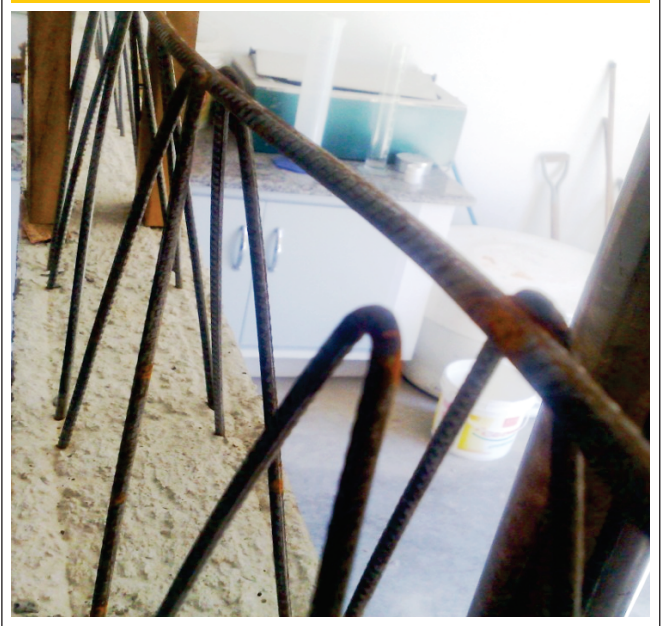
Figura 16 – Ruptura da solda
