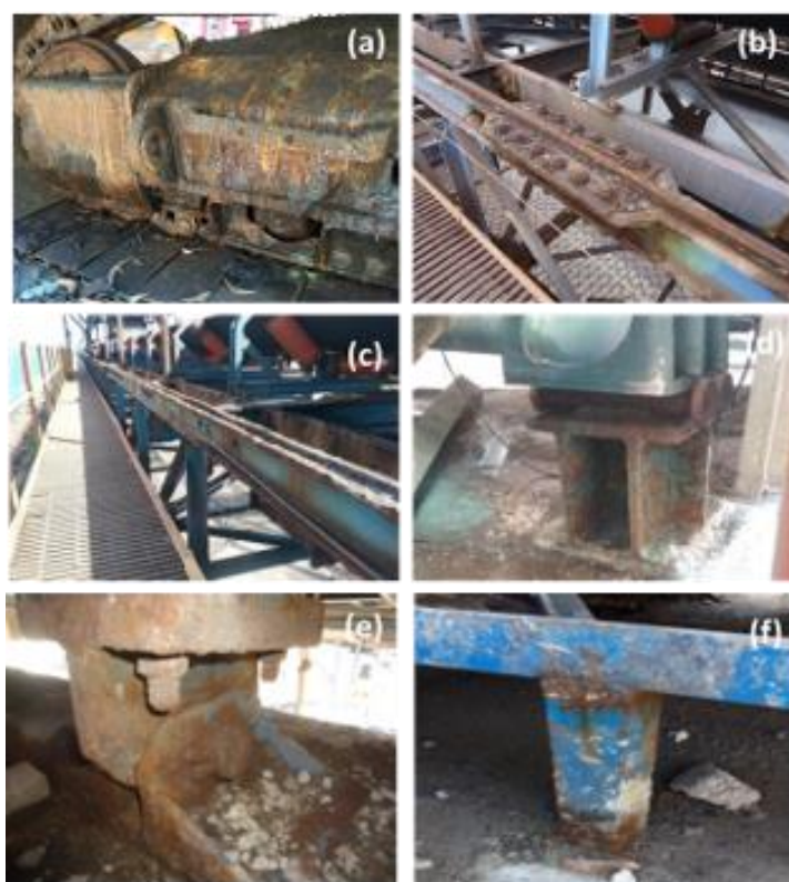
Figura 1: Processos corrosivos em ativos portuários da VALE S.A obtidos pelo Autor em 2019: (a) Esticador de esteira de escavadeira; (b) e (c) Treliça de transportador de correia; (d) e (e); Apoio galeria treliçada e (f) Coluna de deck de transportador de correia.
